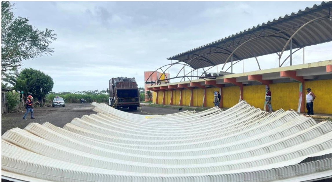
Ilustración 30 Techado de lámina en mal estado en el campo de beisbol de El Mesón
