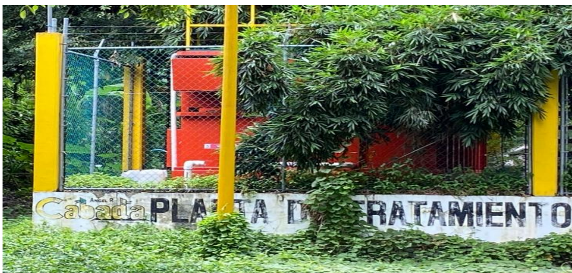
Ilustración 24 Planta de tratamiento de aguas residuales inoperante y observada
